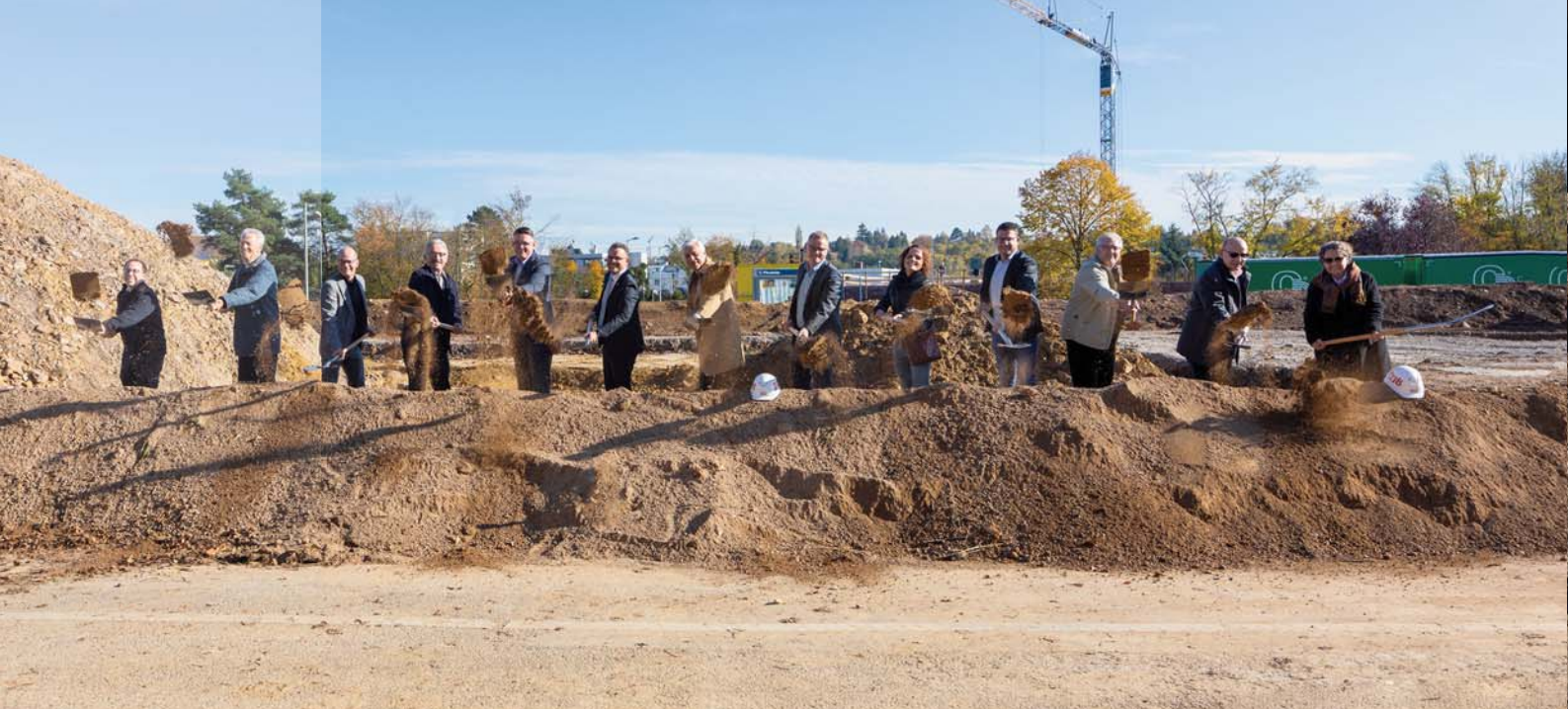
Gute Stimmung am Spaten: Vertreter der Gremien aus Politik und Wirtschaft, darunter OB Boch, eröffnen die Baustelle
